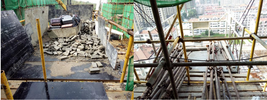
15、现场悬挑层硬防护局部存在缺失现象。
