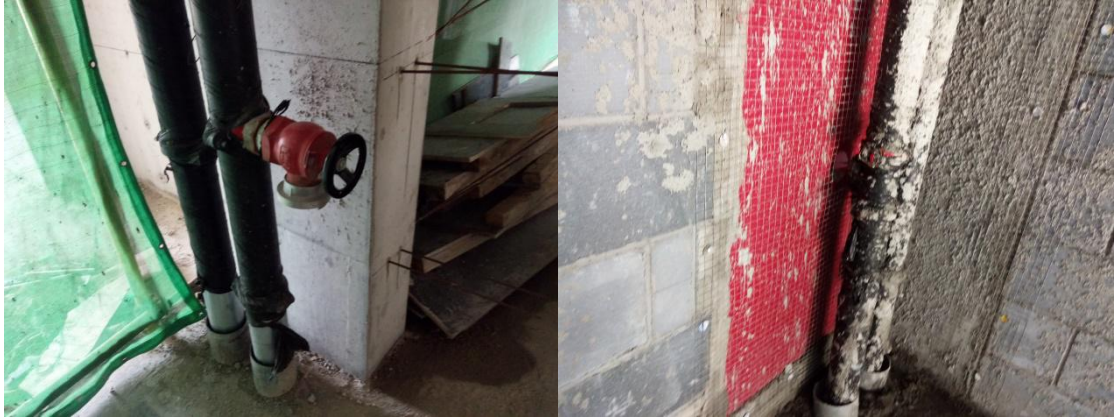
12、外架连墙件数量不足或拆除后未进行恢复。
