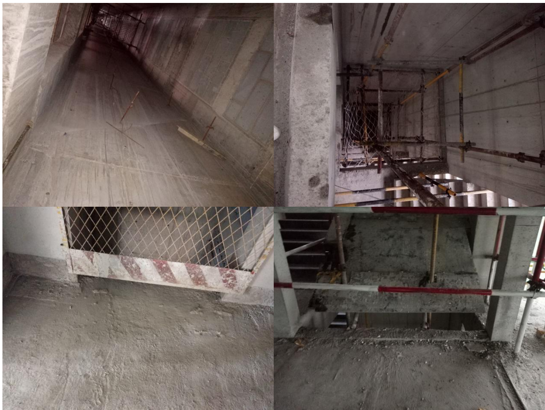
11、高层建筑无临时消防给水系统。
