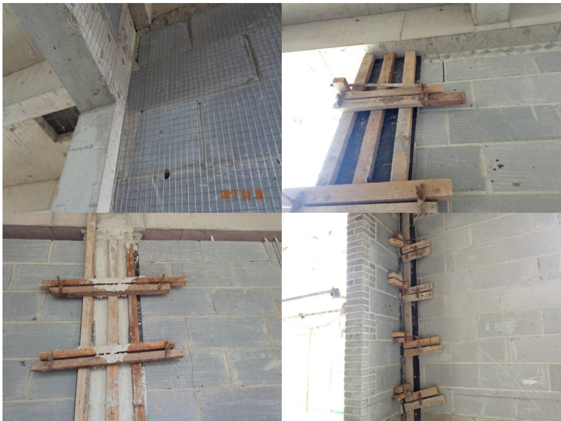
17、现场线管部位采用砂浆进行封堵，线管间距过小。
