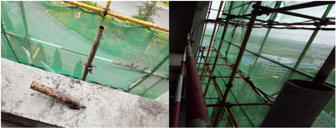
13、动火作业无动火审批，切割作业无防护措施。
