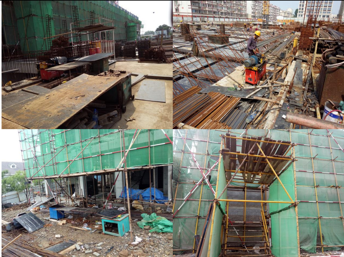
10、电梯井口临边防护缺失、底部未设置挡脚板，电梯井内硬封闭缺失。
