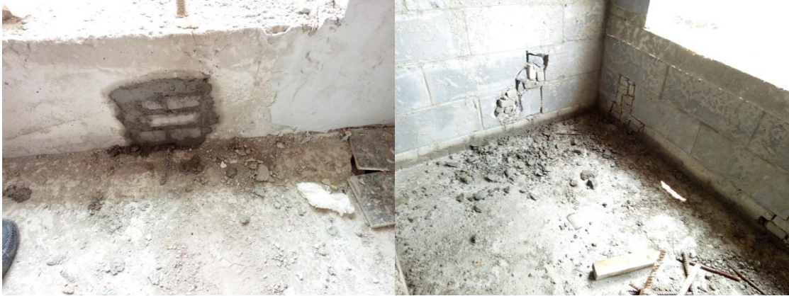
4、卫生间反坎未进行凿毛或凿毛处理不到位，浇筑成型质量差。
