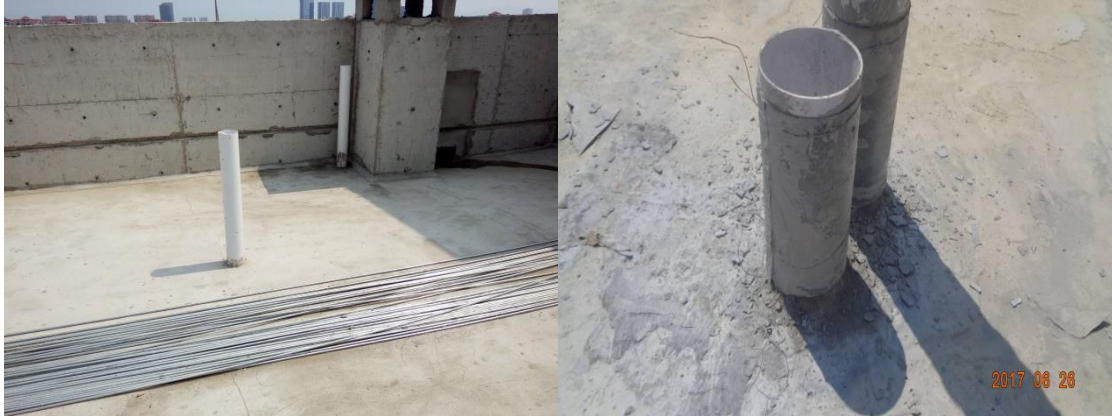
2、结构板存在开裂渗漏现象，影响结构安全。
