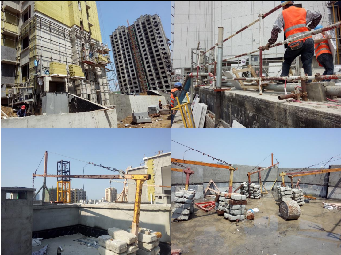
5、工人进入施工场地作业时未佩戴安全帽。
