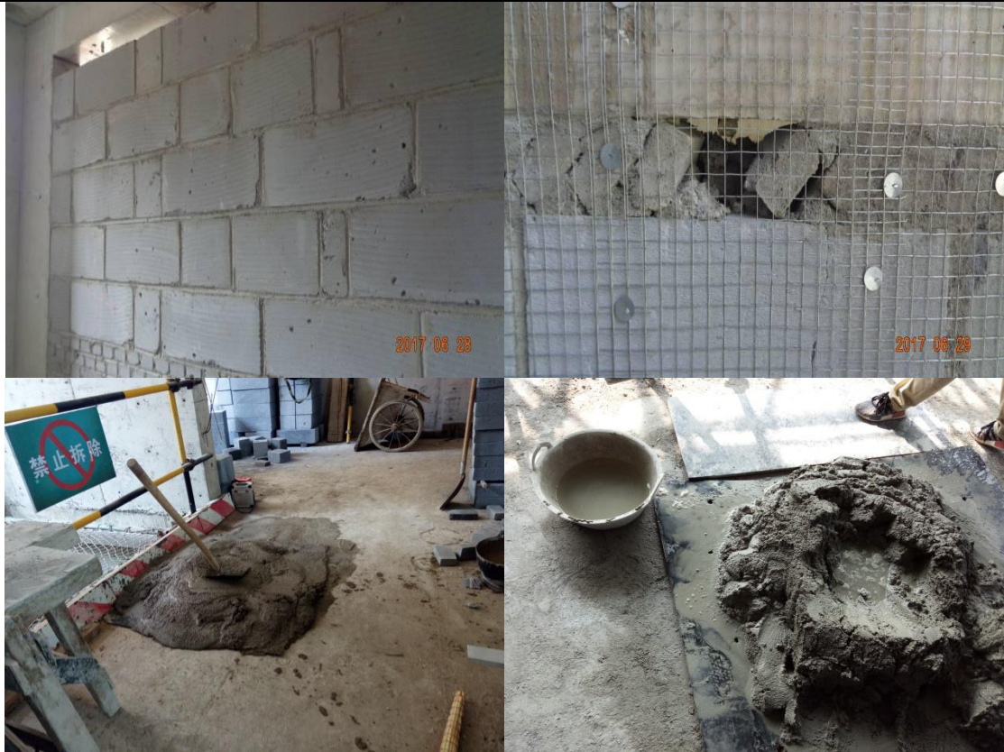
14、现场抹灰前基层未处理到位，高低差部位未进行有效修补，甩浆不均匀，毛刺感不足。
