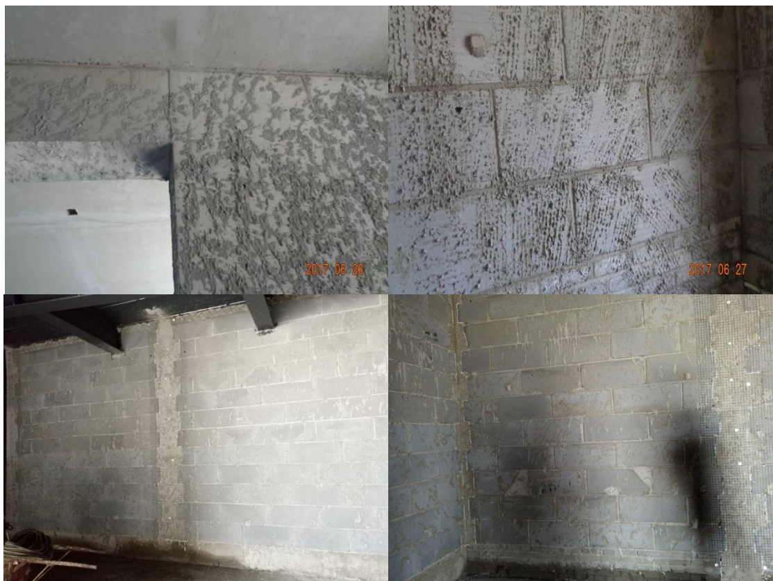
15、抹灰墙面存在空鼓、开裂现象。
