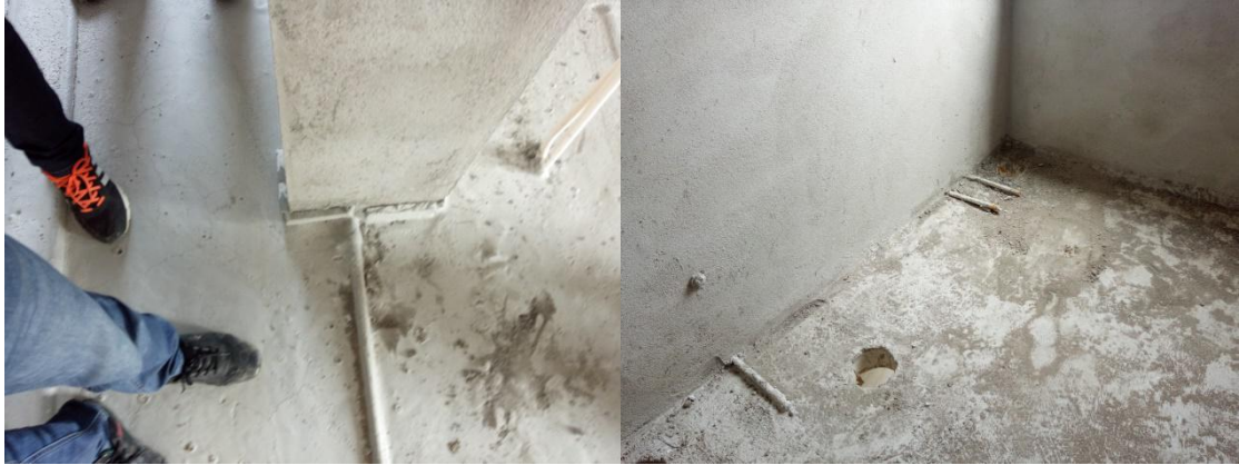
6、屋面烟道未跟随结构一次性浇筑成型。
