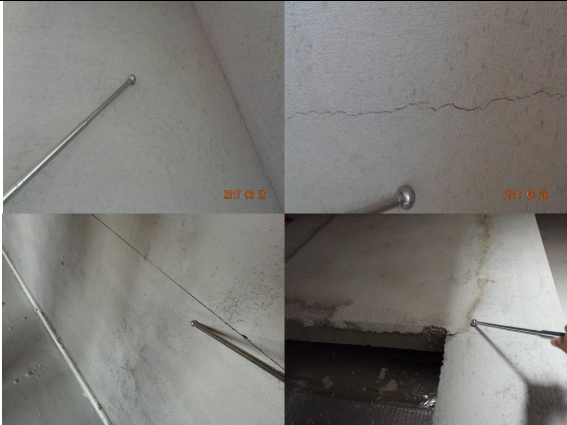
16、现场构造柱使用步步紧穿砌体墙进行加固，易对墙体造成拉裂。
